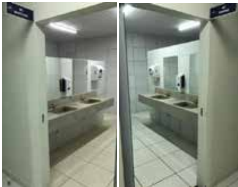
Baterias de Banheiros
